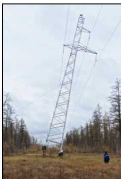
Рис. 2. Опора ЛЭП, которая сильно накренилась в результате неравномерного выпучивания свай
