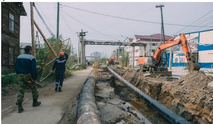
Рис. 1. Вскрытие дорожного полотна для замены устаревшего газопровода по улице Чайковского, г. Якутск
